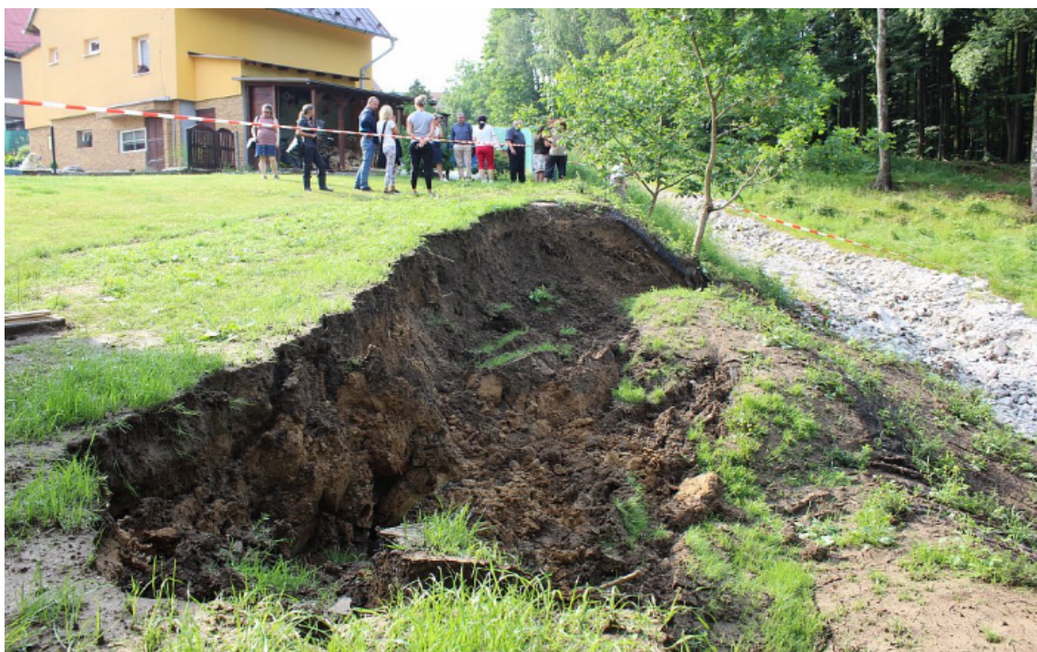
Obr. 13: Část sesunutého svahu v Havířově (3. června 2018)
